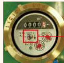
水道メーター
