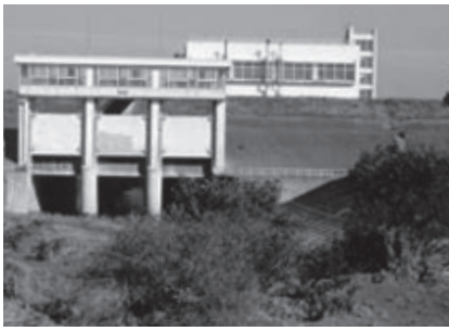
30m 3 /秒の排水ポンプ場 (曲師地先)
