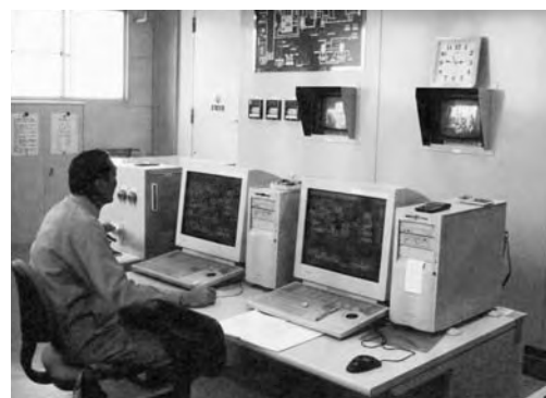
環境センター コントロール室
