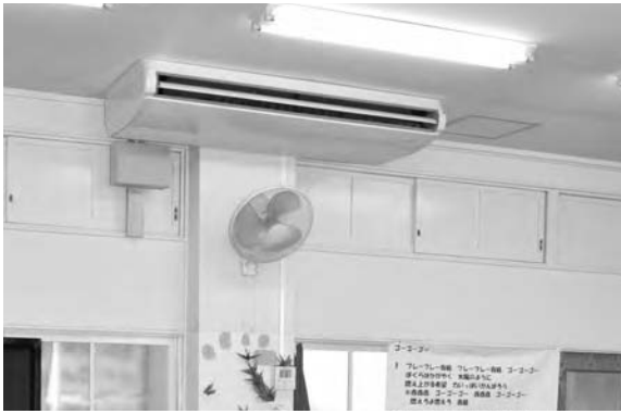
幼稚園・小中学校に設置されたエアコン
