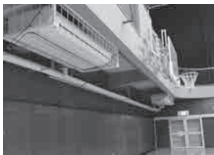
指定避難所となる体育館のエアコン
