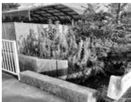
川島中西側の転落防止用柵がなくて危険な水路
