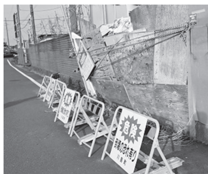
町道に倒壊しそうな産業廃棄物
