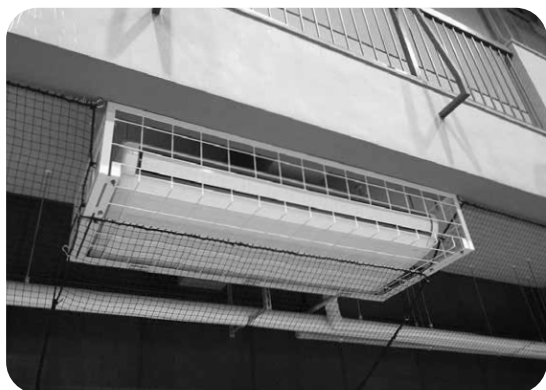
町民体育館にエアコンが設置されました
