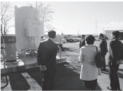
▲学校給食センターに設置されたLPGガス災害用バルク
