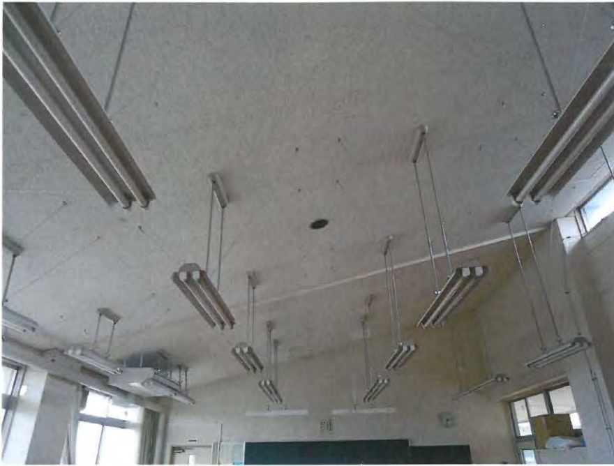
仕上ユニット工事 吊照明取付補強 補強金具取付状況 [美術室]
