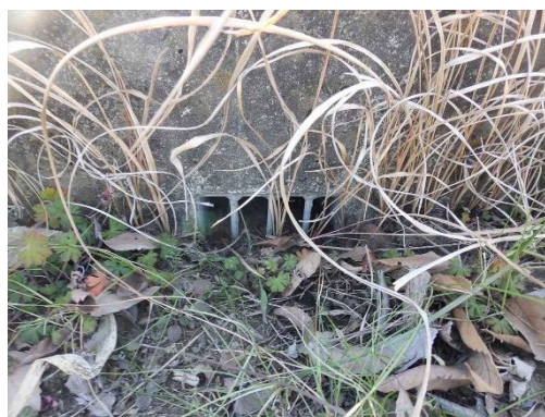
1.1.7 排水装置の土砂詰り
