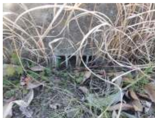
写 3.1 排水装置の土砂詰り
