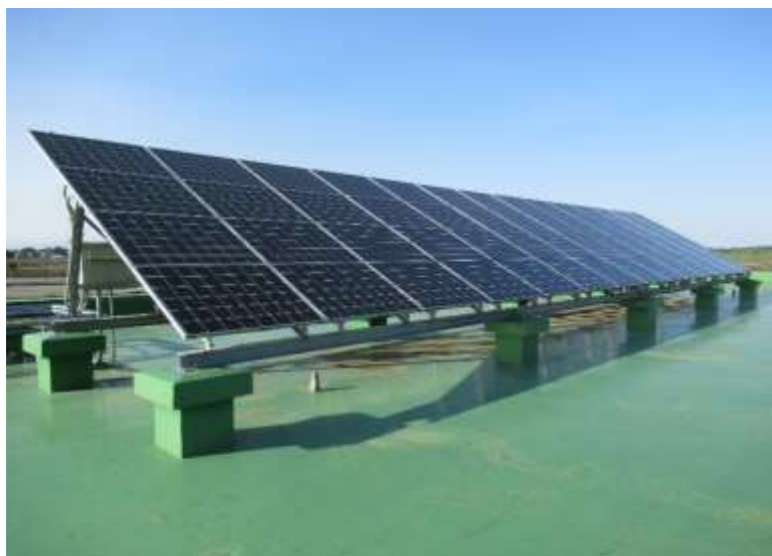
太陽光発電パネル(屋上)
