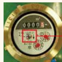
水道メーター
